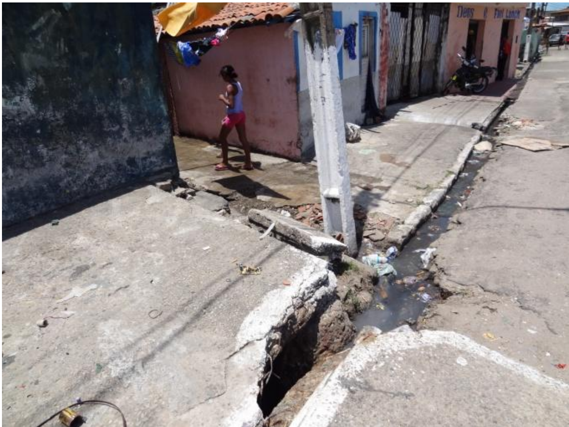
Figura 34 - Esgoto doméstico a céu aberto
