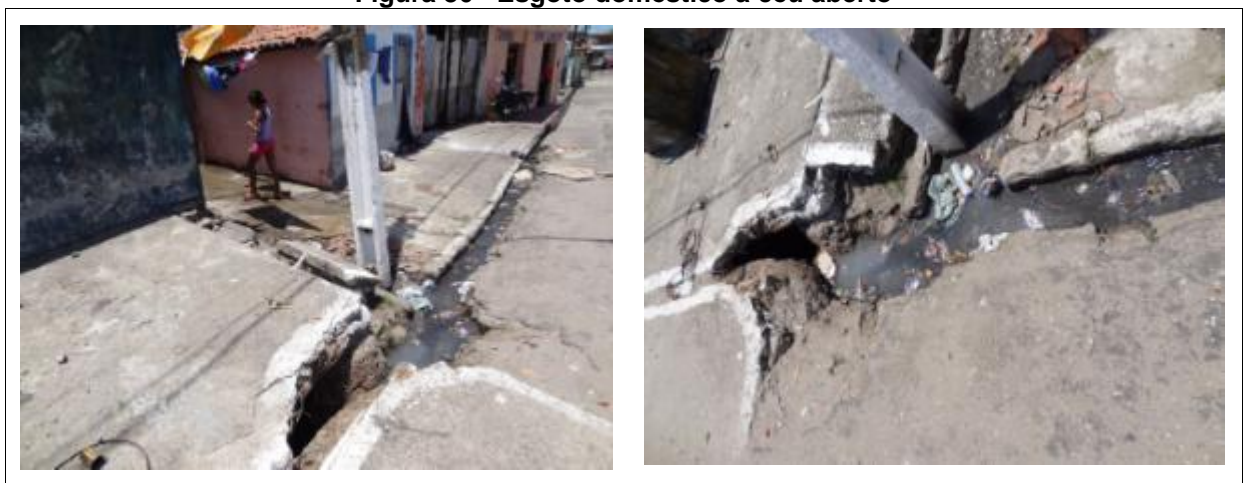
Figura 86 - Esgoto doméstico a céu aberto
