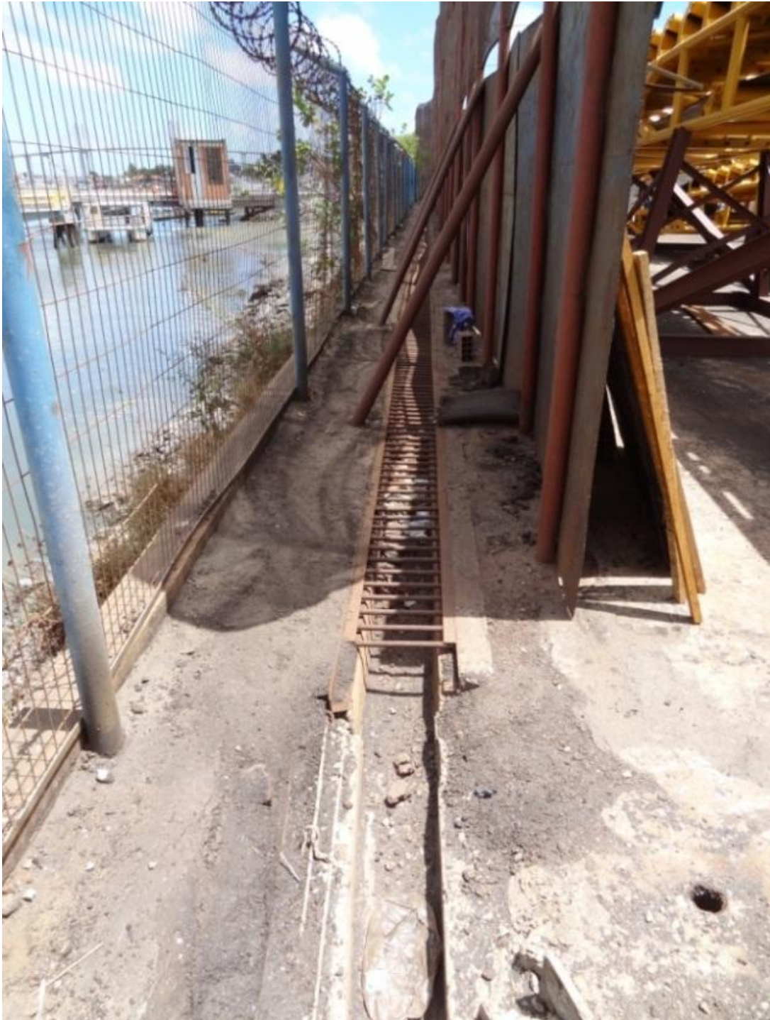
Figura 37 - Calha de água pluvial, com acúmulo de minério de ferro
