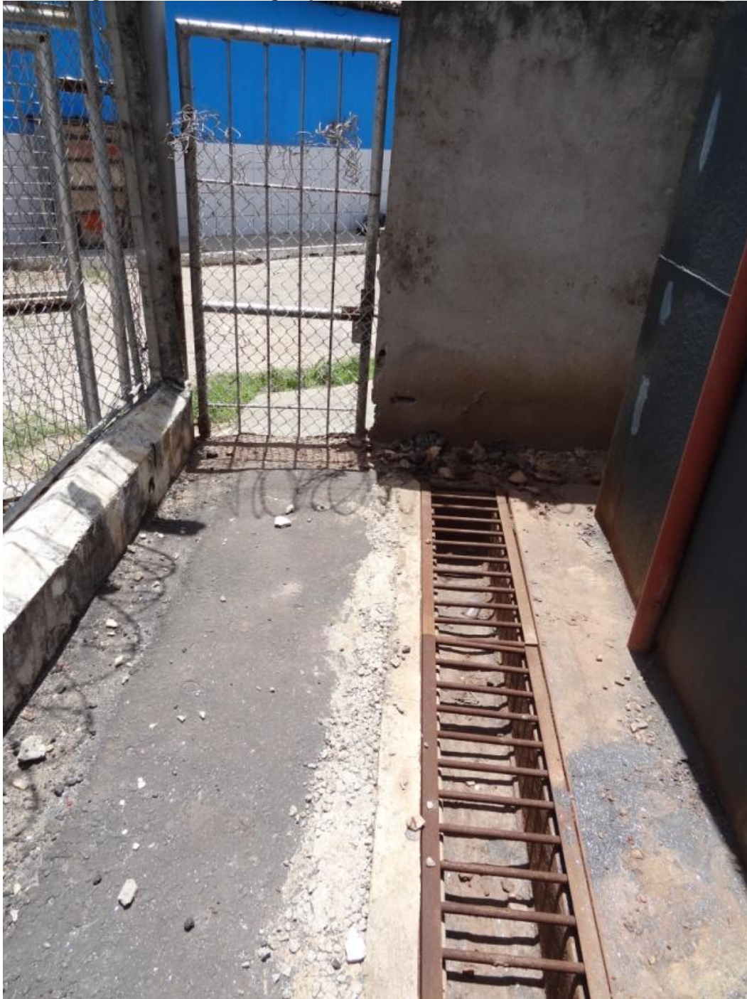
Figura 39 - Calha de água pluvial, com acúmulo de minério de ferro
