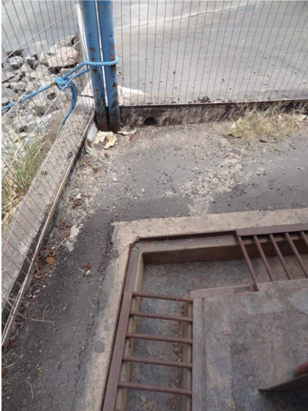
Figura 38 - Calha de água pluvial, com acúmulo de minério de ferro
