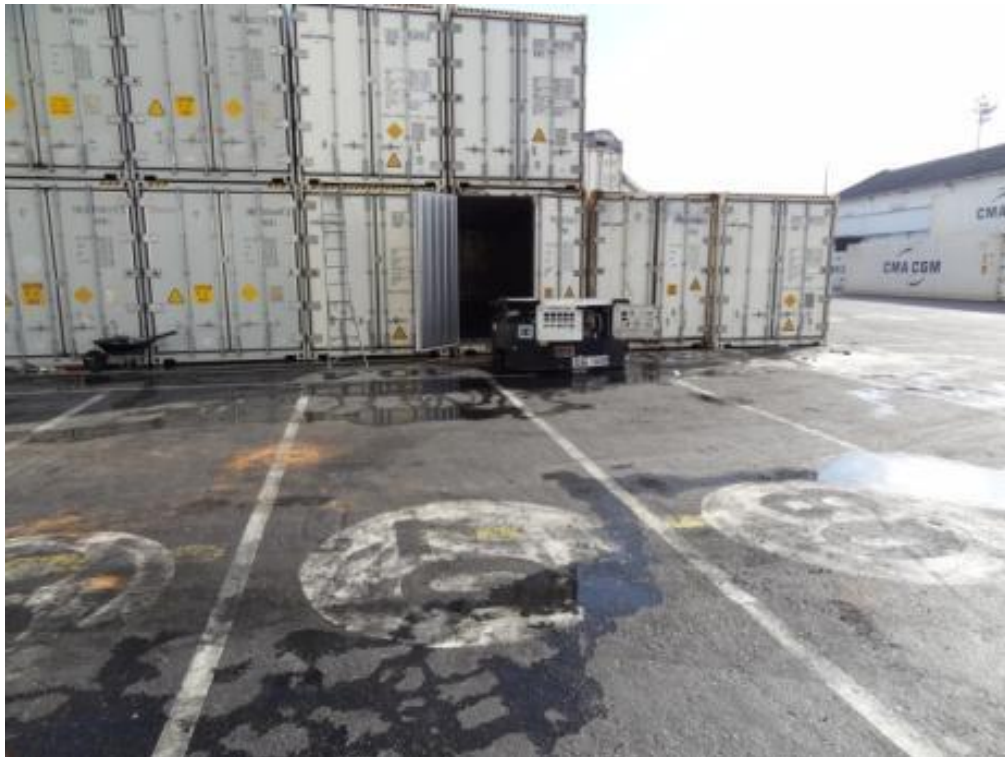
Figura 68 - motor de geração de energia elétrica movido a óleo combustível para containers
