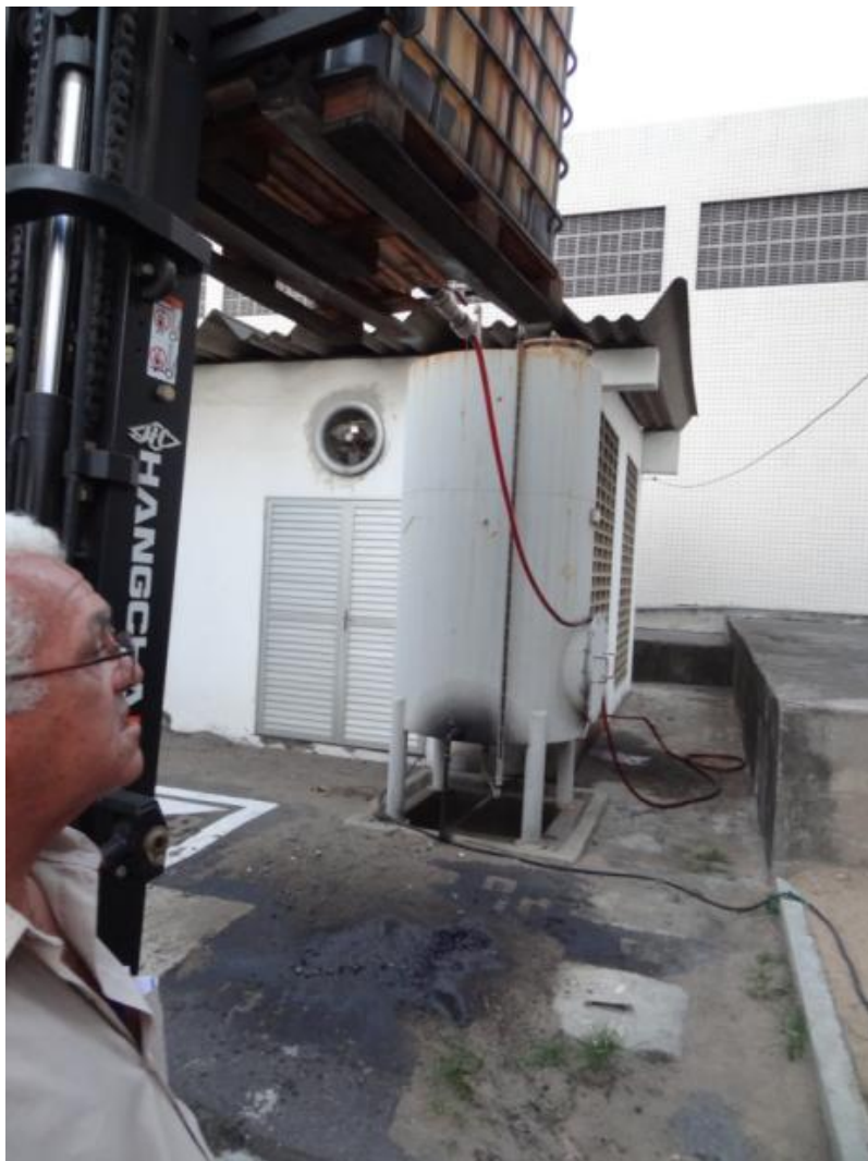
Figura 67 - Acompanhamento do abastecimento de óleo combustível nos geradores da Subestação
