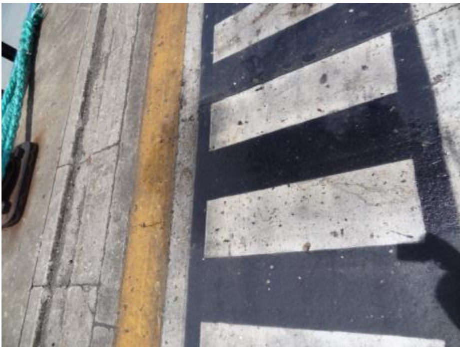
Figura 47 - Manchas de óleo no cais do Porto
