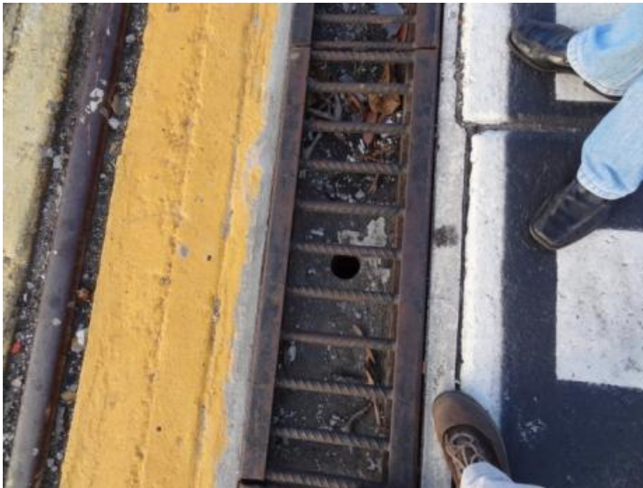
Figura 46 - Sistema de drenagem das águas superficiais no cais do Porto
