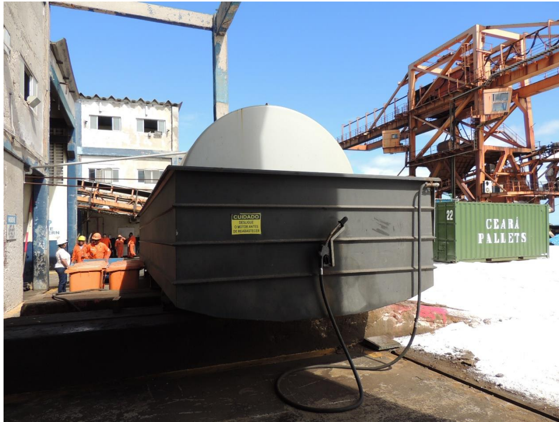
Foto 20 – Tanque de armazenamento de óleo diesel com capacidade para 25.000 litros que encontra-se provisoriamente instalado próximo à oficina.
