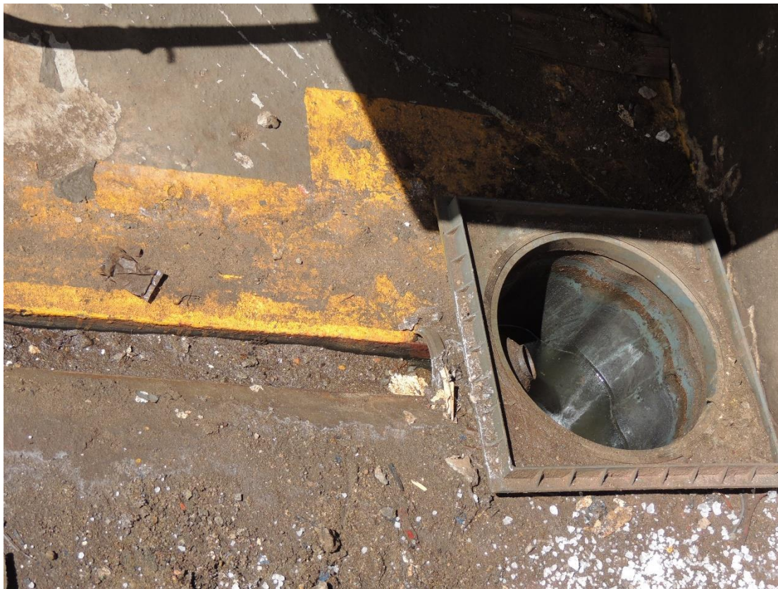
Foto 31 – Caixa da drenagem e resíduos na claha de drenagem da oficina.
