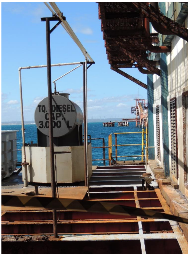
Foto 23 – Tanque de armazenamento de óleo diesel que abastece o gerador. Capacidade para 3.000 litros.
