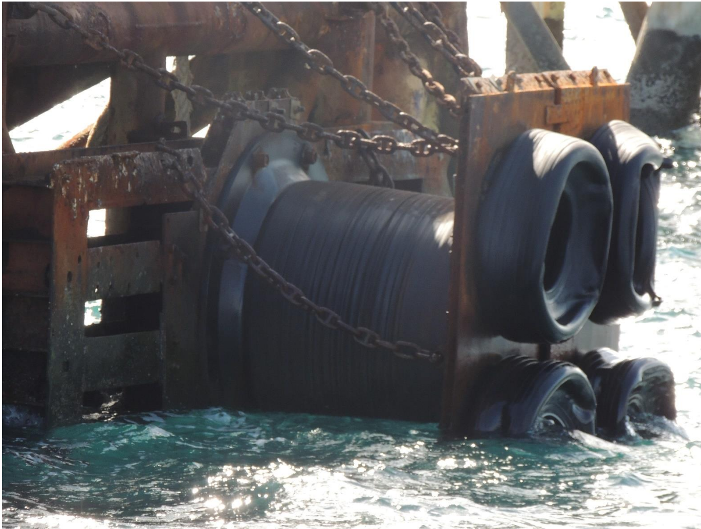
Foto 11 – Defesa de número 04 recuperada com placa de ferro e pneus para amortecimento. Defesa de menor porte em relação as 1 e 5.
