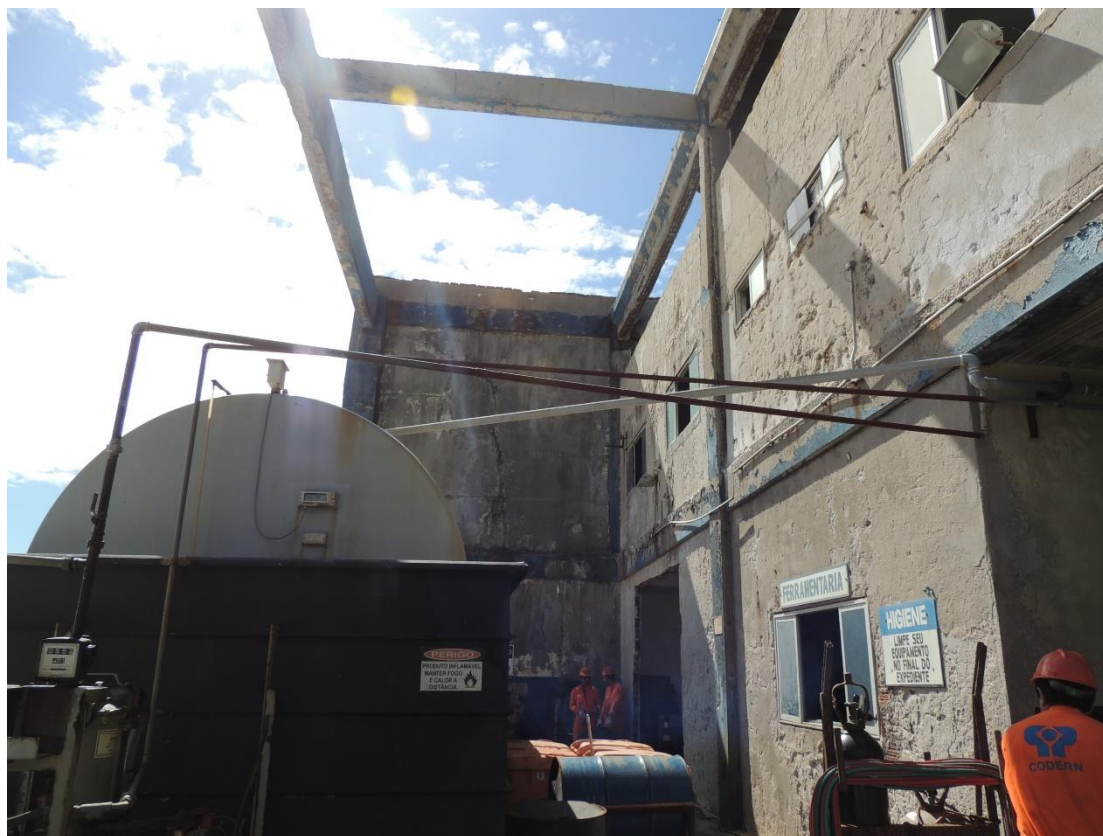
Foto 27 – Estrutura de duto aéreo instalado provisoriamente para comunicar o tanque de armazenamento ao tanque que abastece o gerador.
