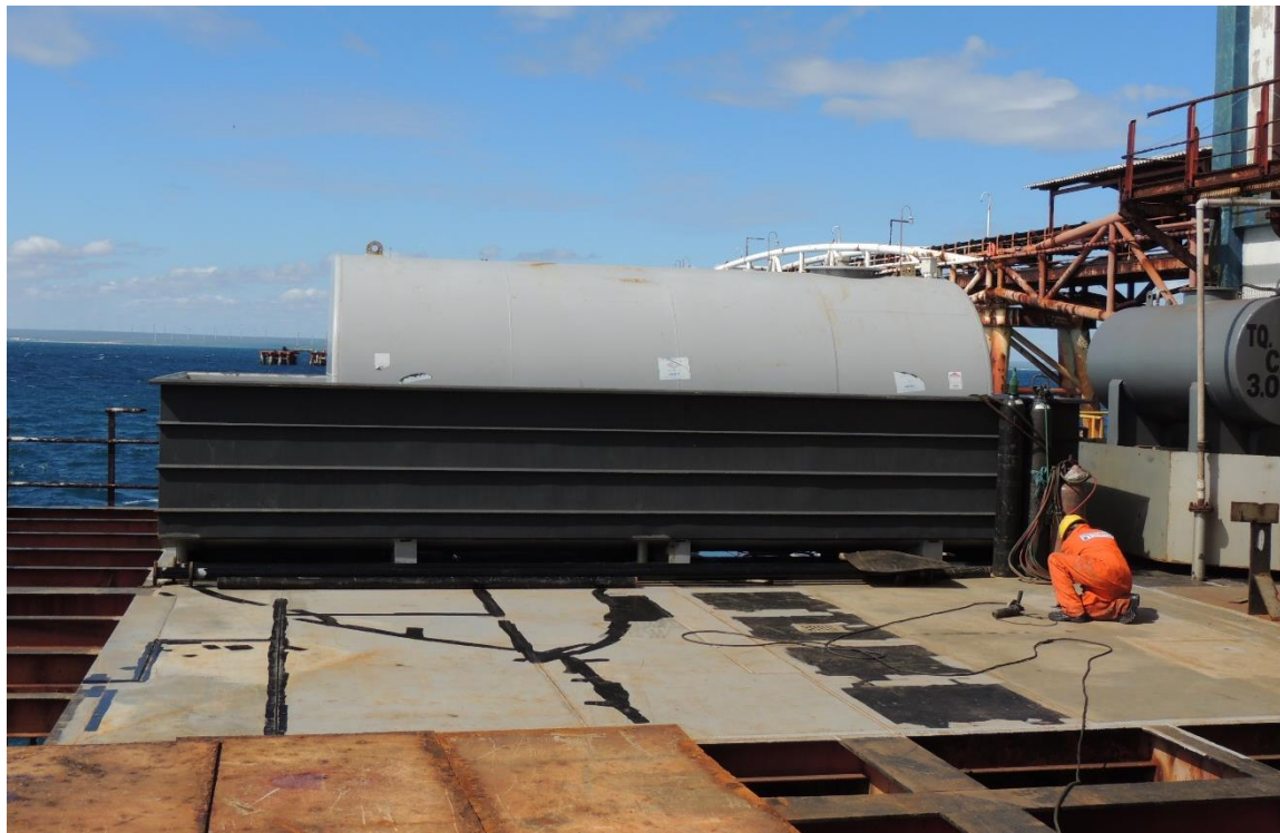
Foto 21 – Segundo tanque de armazenamento já instalado na área do Terminal destinada a tancagem. Capacidade de 25.000 litros de armazenamento. Ainda não estava em uso no momento da vistoria.
