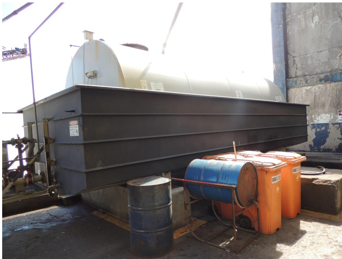
Foto 51 – Kits com material de contenção e recolhimento de óleo “em terra” localizados no terminal próximos ao tanque de armazenamento e oficina.
