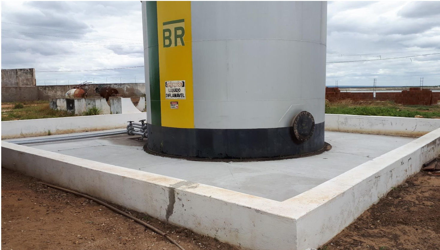
Foto 37 – Tanque de armazenamento de óleo diesel com capacidade para 100.000 litros dentro da área de contenção.
