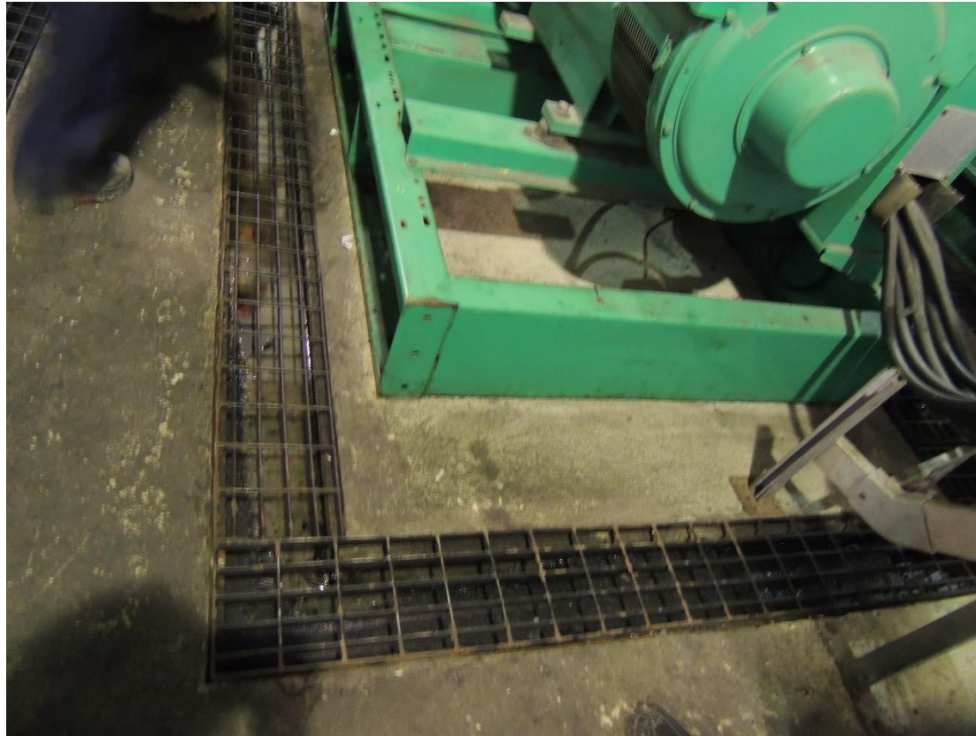
Foto 34 – Calha no entorno dos geradores para contenção de óleo lubrificante.
