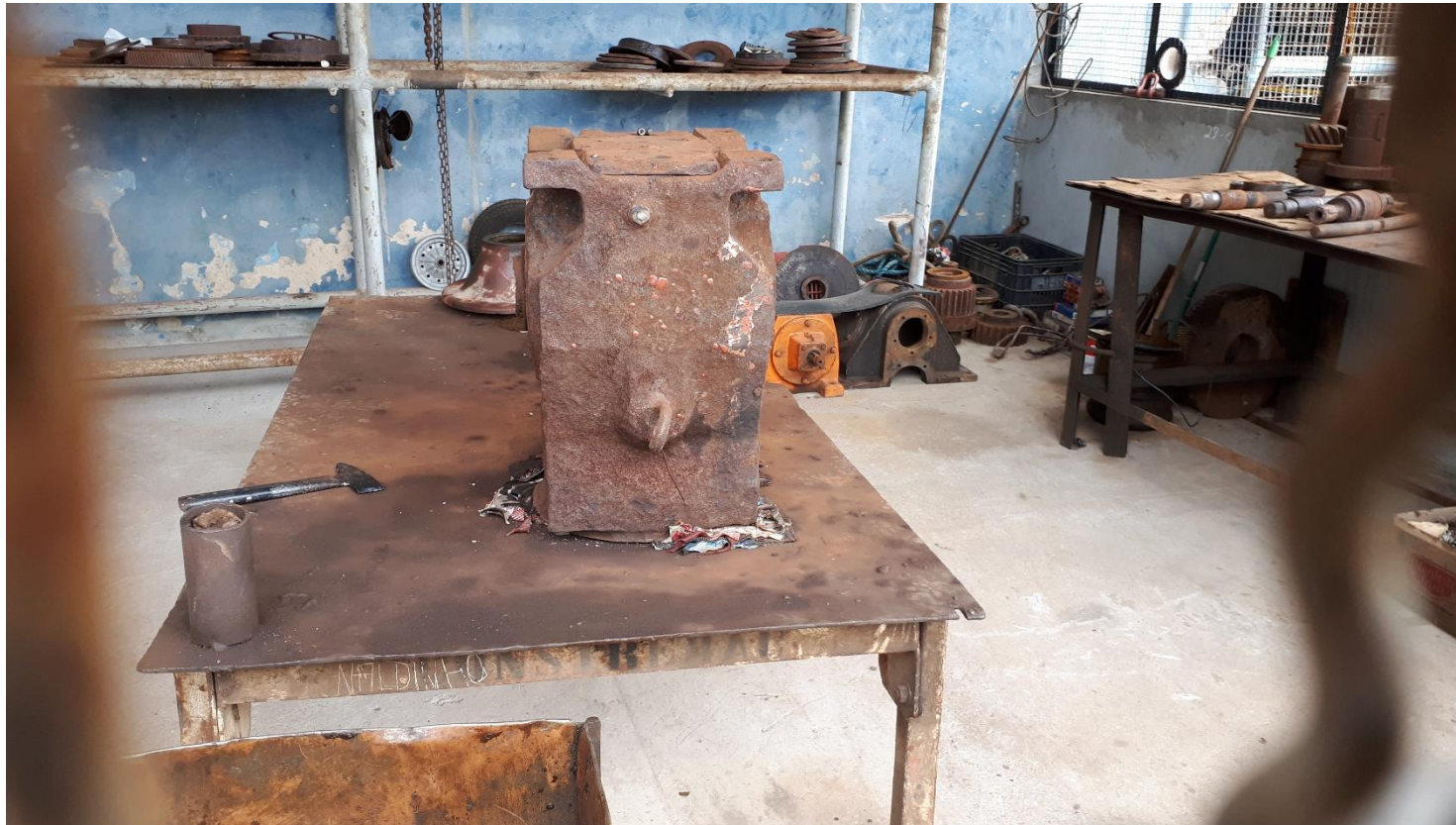
Foto 45 – Local da oficina mecânica destiando para a abertura de máquinas/equipamentos. Possui calha de drenagem, mas o piso não estava impermeabilizado.
