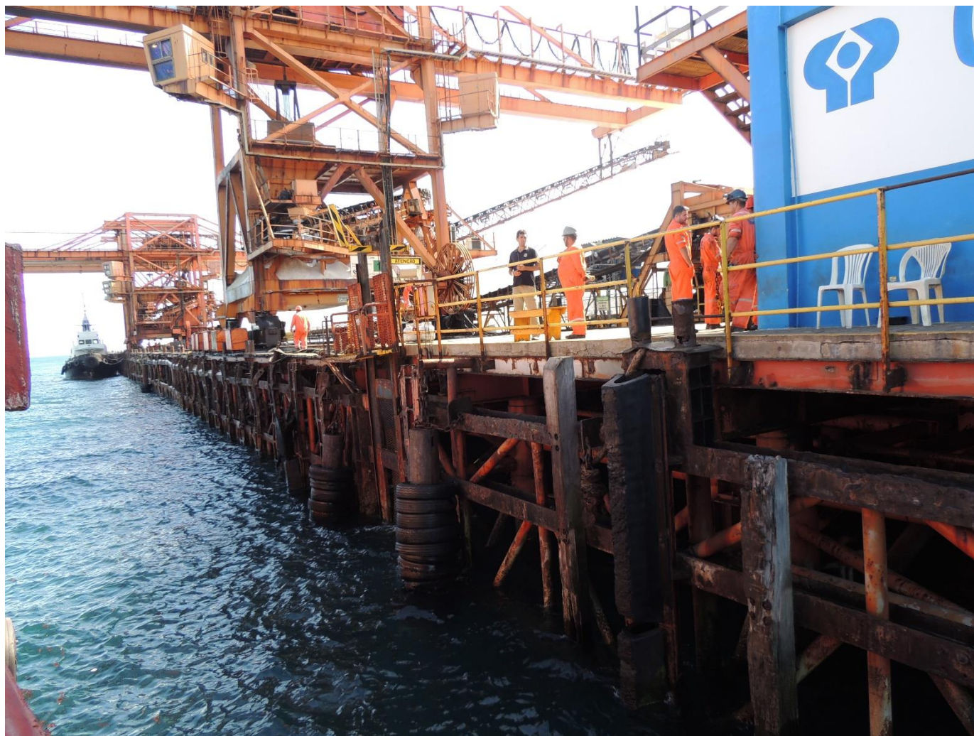
Foto 14 – Trecho do cais barcaça contíguo onde atracam as lanchas para desembarque de pessoal sem defensas.
