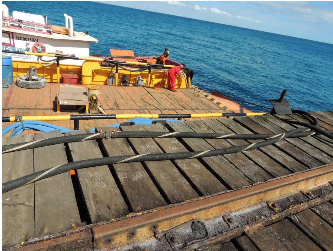
Foto 26 – Mangote utilizado para conectar a embarcação ao duto que transporta o óleo diesel até o tanque de armazenamento.
