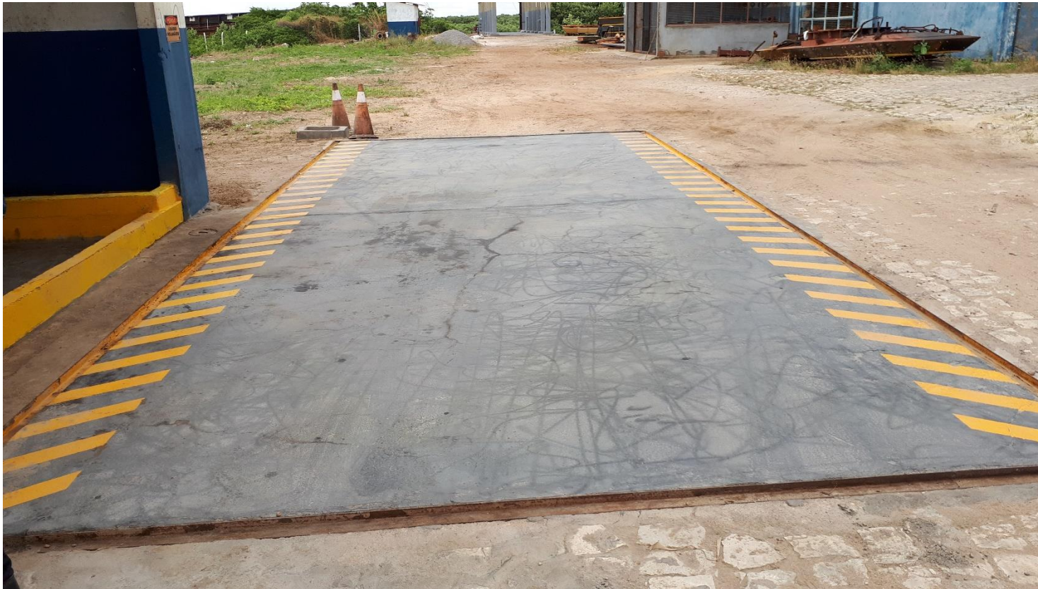
Foto 39 – Área com piso impermeabilizado e calha de drenagem para veículo da empresa que realiza o abastecimento do tanque.
